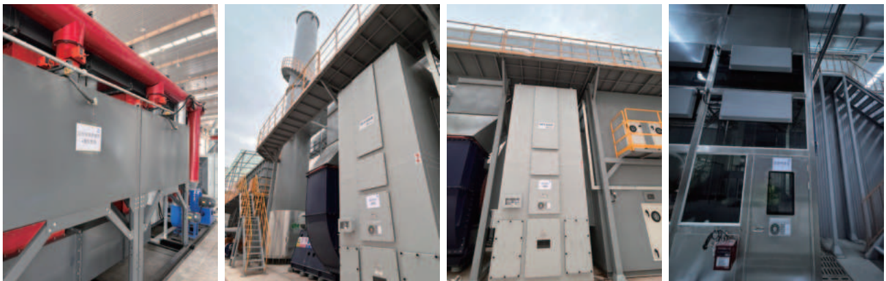
方大（赣州）低碳智造总部基地环保设施
